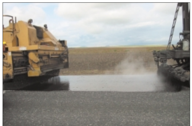
Við útlögn er mikilvægt að mölinni sé dreift samstundis yfir heitt bindiefnið. Sjálfkeyrandi malardreifari getur fylgt asfalt-dreifibíl fast eftir.
